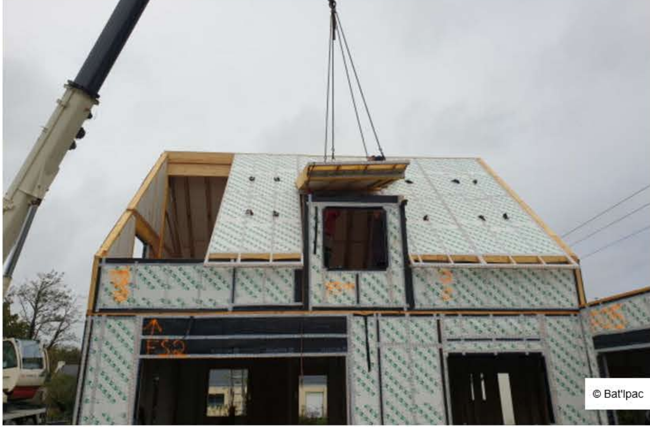
La maison est isolée avec les blocs Ipac de la société Bat'Ipac, des plaques de carton alvéolaires recouvertes d'une membrane d'étanchéité.
